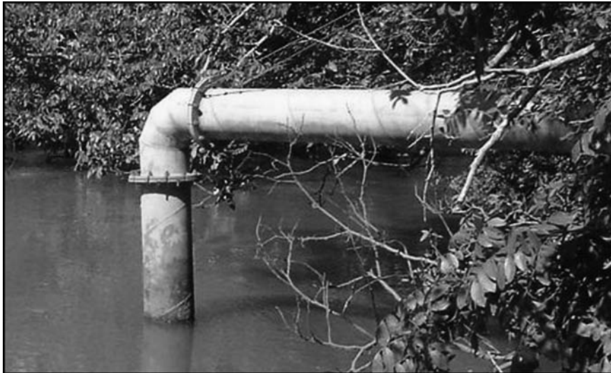
Figura 20. Tubulação de sucção.
